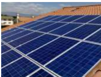
Es. Impianto fotovoltaico
