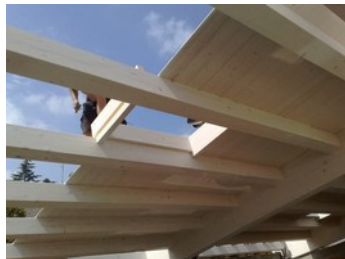
Es. Tetto in legno
