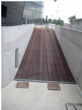
Es. Rampa riscaldata
